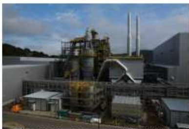
飯舘村葦平地区の仮設焼却施設 (平成27年12月)
